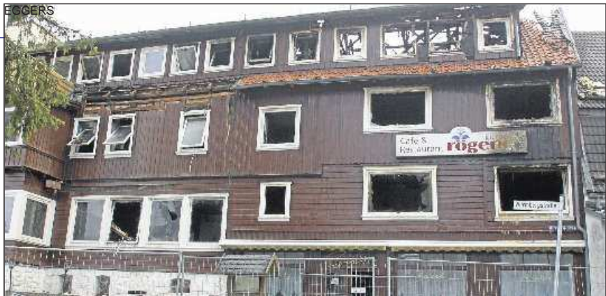
Ein Bild der Verwüstung bietet das Kurhotel Rögener am Tag nach dem verheerenden Brand. Foto: Eggers
